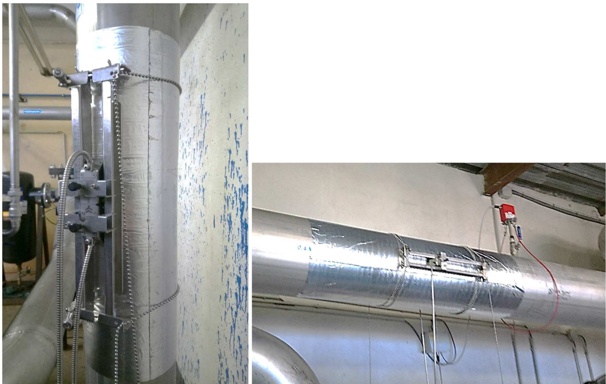
Obr. 3 Meranie č. 1 prietoku na vertikálnom potrubí 6 bar a č. 2 na horizontálnom 4 bar
